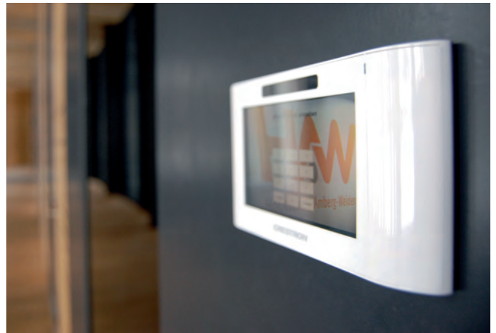
↑ Das Touchpanel »TPMC-4-SM« im Eingangsbereich des Gebäudes wird vom Schließdienst für das zentrale Ausschalten der Gebäudetechnik genutzt.
